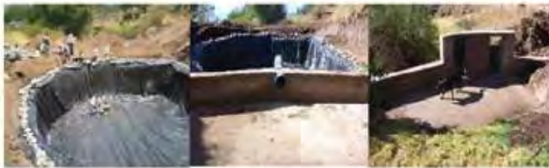
Foto 7: geo membrana y canal de drenaje instalados. Foto 8. Muro a la entrada del tanque. Foto 9: pared de 2 compuertas a entrada del cañón
