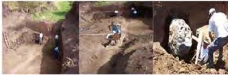
Fotos 1 y 2: excavación con retro excavadora (10 horas) y 15 días (45 días hombre) de trabajo a mano. Foto 3: Complicaciones: una piedra en la excavación
